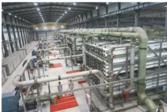
图 3.14 河北唐山曹妃甸的海水淡化车间
