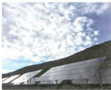
图 1.11 西藏冈底斯藏医学院的太阳能光伏电站
