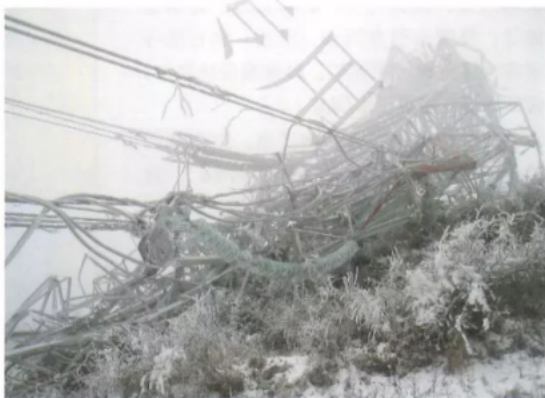
图6.8 寒潮破坏输电线路
